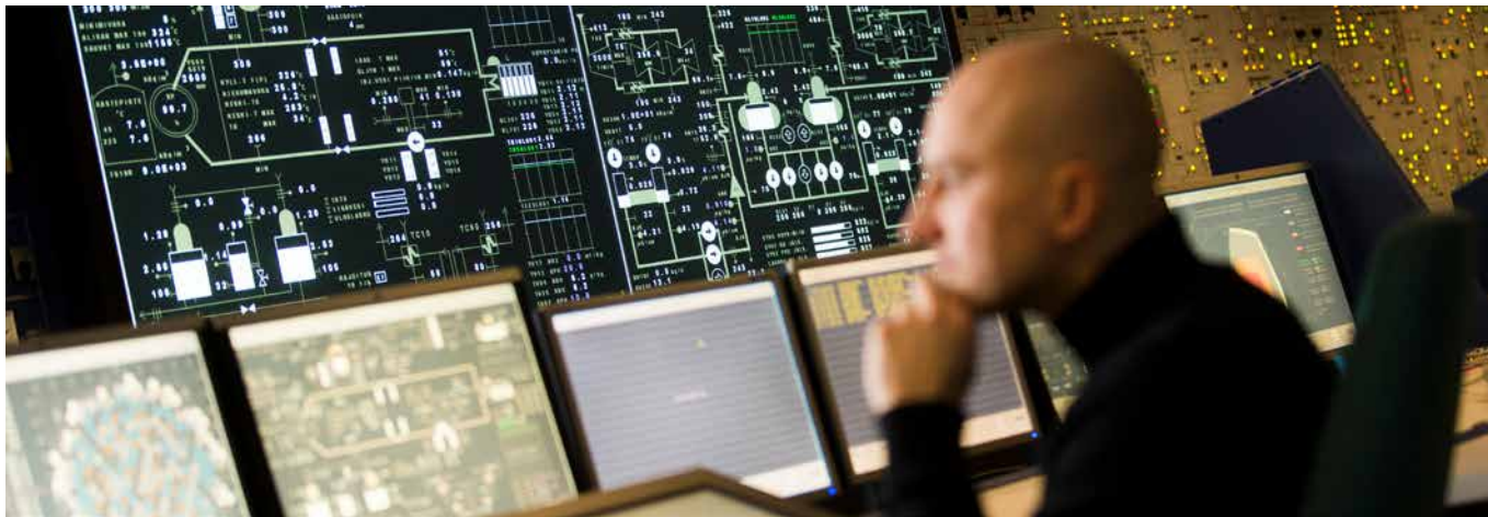
Voimalaitosta on kehitetty pitkäjänteisesti jatkuvan parantamisen periaatteella. Automaatiouudistus toteutettiin vuosina 2009-2019.
