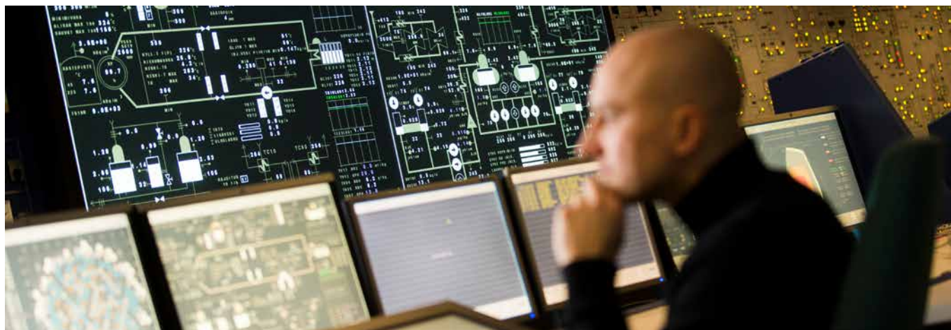
Kraftverket har utvecklats långsiktigt i enlighet med principen om ständig förbättring. Delar av automation har förnyats under åren 2009 - 2019.
